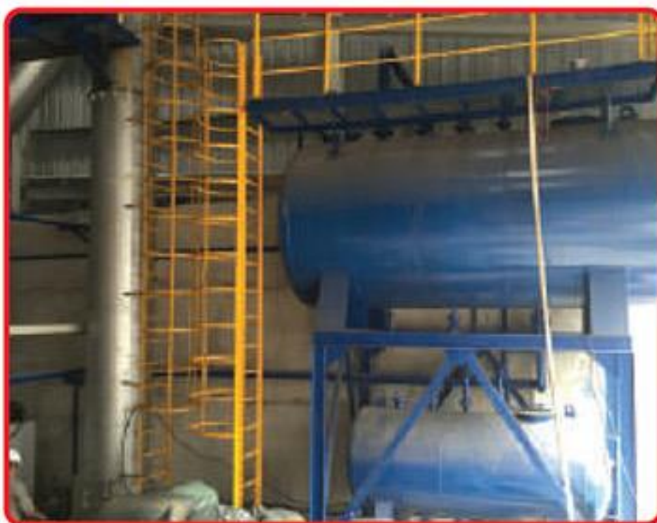
5 Hệ thống thu hồi nước ngưng
