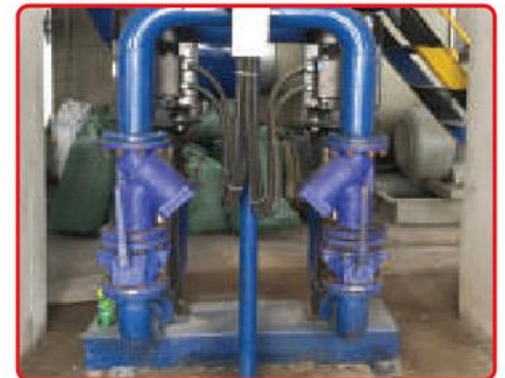
4 Bơm nước cấp
