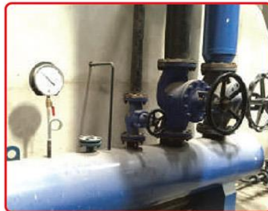
2 Bình góp hơi nước
